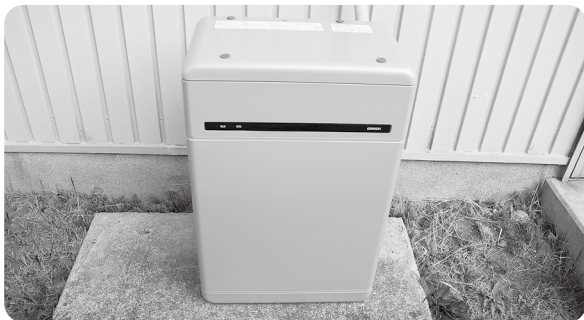
▲蓄電池は100V蓄電が可能
